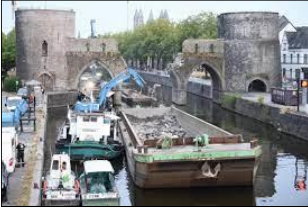
Figure 20 - Exemple de démolition d'un ouvrage sur rivière avec prise en charge des produits de démolition directement par barge
