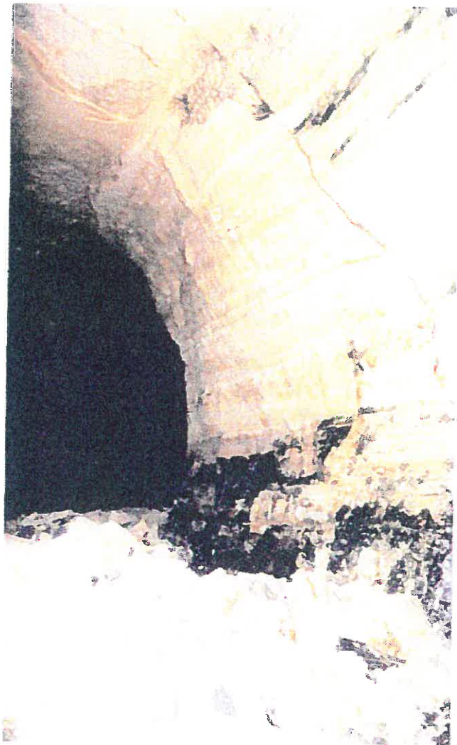
Fig 5 : Ecaillage d'un pilier
