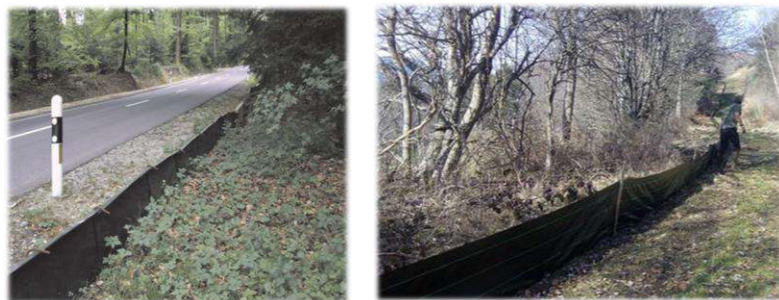
Exemple de dispositif de la mise en défens : plaques rigides (à gauche) et bâche souple (à droite)
