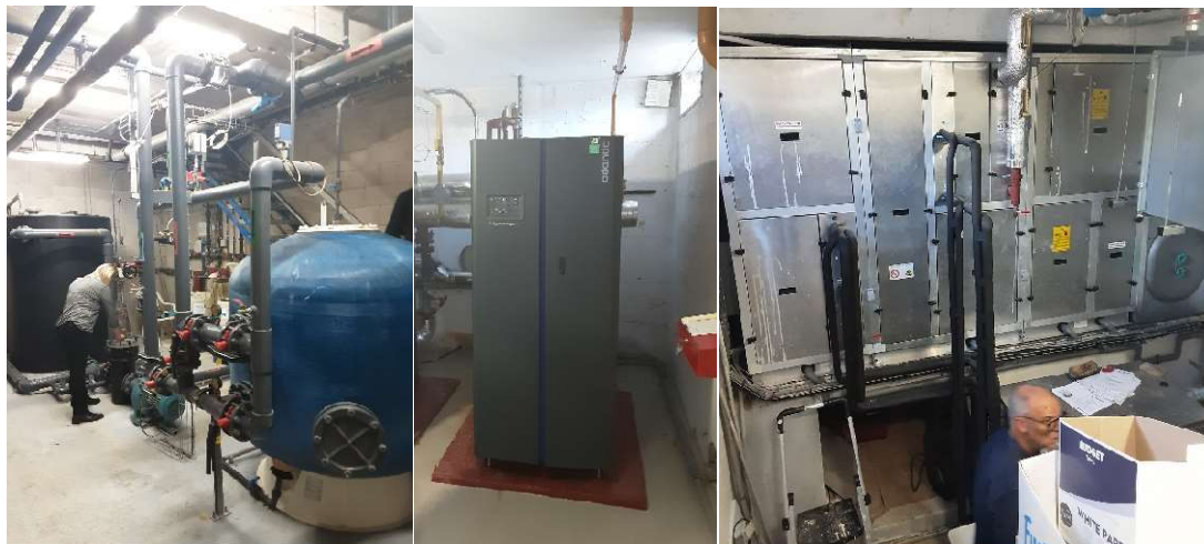
Figure 9 De gauche à droite local filtration pataugeoire / chaudière VARMAX / CTA halle bassin
