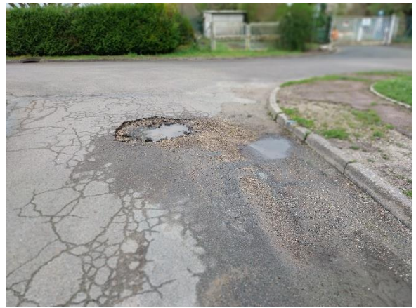
Etat dégradé des enrobés
